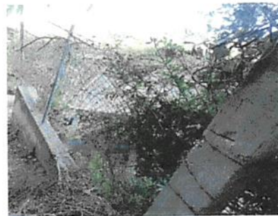
Foto 6: Maya en muro perimetral
